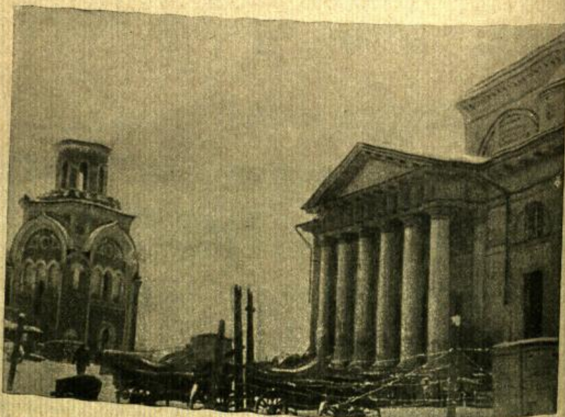
3. ТОРЖОК. Угловая башня Борисоглебского монастыря, пострадавшая от действия немецко-фашистской авиации. Фото арх. А. С. Фуфаева
