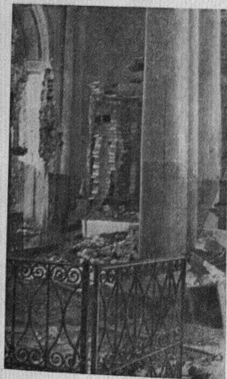
16. ЯРОПОЛЕЦ. Церковь при усадьбе Чернышевых. Деталь по- вреждения в церкви. Фото арх. А. С. Фуфаева. Февраль 1942 г.
