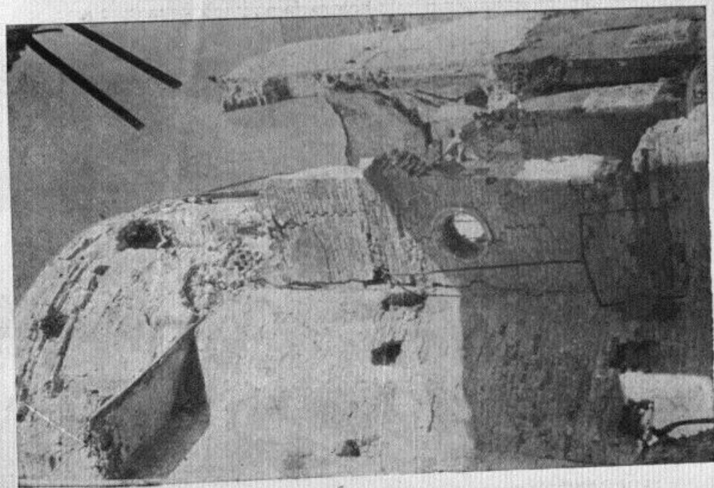
8. БОГОРОДИЦК. Бывш. дворец графа Бобринского. Внутренние стены центральной части здания, разрушенные в период немецкой оккупации. Фото арх. А. С. Фуфаева, 1942 г.
