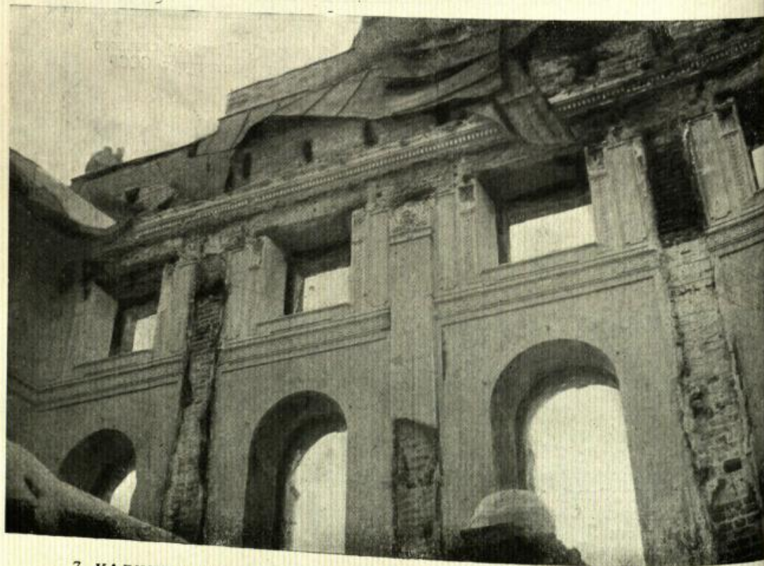
7. КАЛИНИН. Здание облисполкома (б. Путевой дворец). Южная стена главного зала после разрушения.
