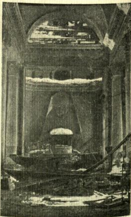
17. ЯРОПОЛЕЦ. Церковь при усадьбе Чернышевых. Поврежде- ния в абсиде мавзолея Захара Чер- нышева. Фото арх. А. С. Фуфаева
